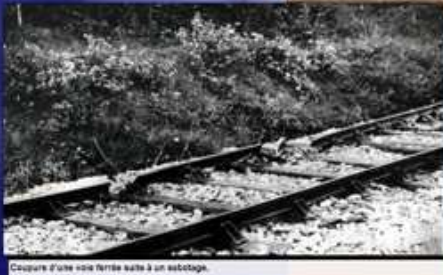
Coupe d'une voie ferrée suite à un sabotage.
